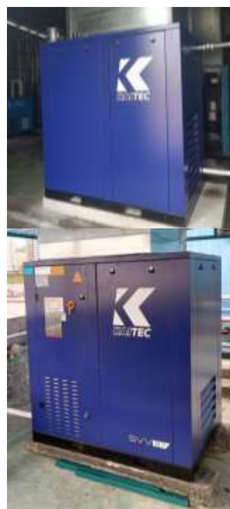
2 台 37kW 永磁電機及變頻的空氣壓縮機
